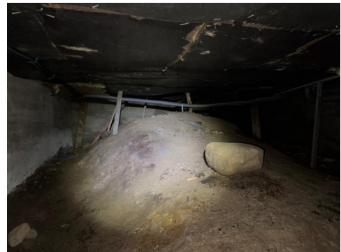
Asfaltplater oppunder bjelkelag i kryptjeller henger og er stedvis enkelt støttet opp med div. planker.
