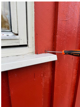
Råte og mangelfull luft/dryppspalte
