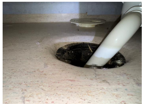
Utilgjengelig sluk under dusjkabinett
