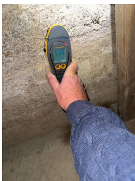
Forhøyde utslag i kjellervegger på fuktindikator.
