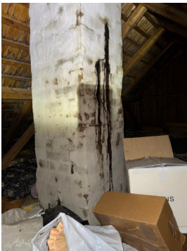
Pipeløp på loft med bekkmerker.
