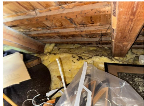
Isolert tett mot undertak uten synlig luftespalter.
