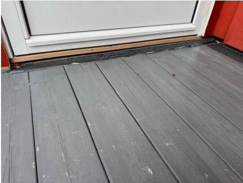
Svært liten kant mellom gulv/dørterskel.
