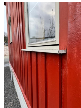
Vannbrett under vindu med feil fall (motfall)
