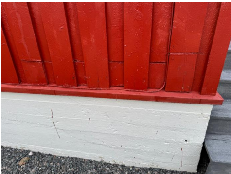
Utskiftet kledning med "grove" skjøter.
