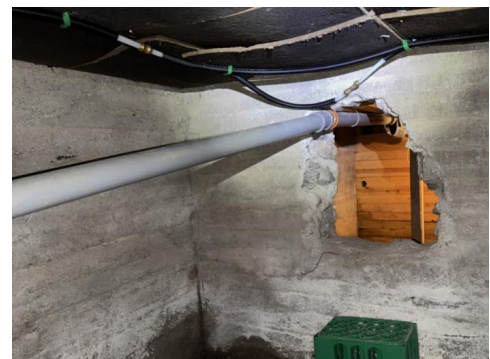
Uisolerte vannrør i krypkjeller
