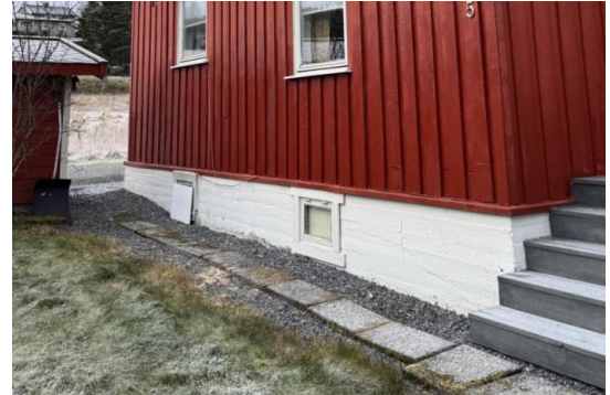
Ingen synlig fuktsperre.
