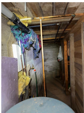
Eldre uisolerte kobberrør i kjeller
