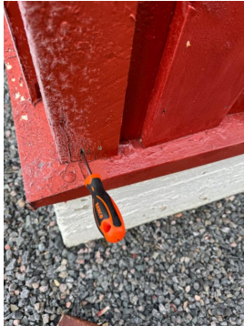
Råteskader kledning og mangelfull luftning/dryppkant mellom vannbrett/kledning.
