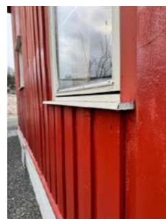
Manglende beslag under hoveddør.
