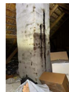
Pipeløp på loft med bekkmerker.
