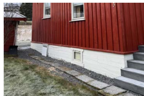
Ingen synlig fuktsperre.
