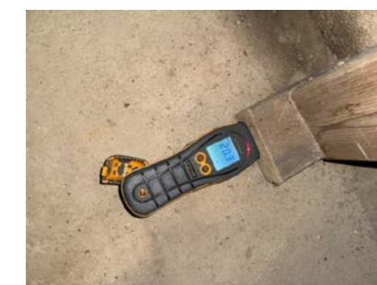
Forhøyede fuktverdier i treverk mot gulv/betong
