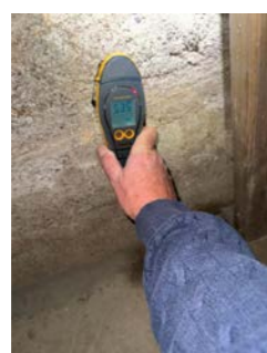
Forhøyde utslag i kjellervegger på fuktindikator.
