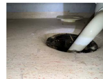
Utilgjengelig sluk under dusjkabinett
