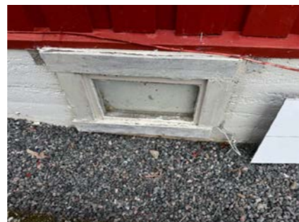
Vannbrett under vindu med feil fall (motfall)
