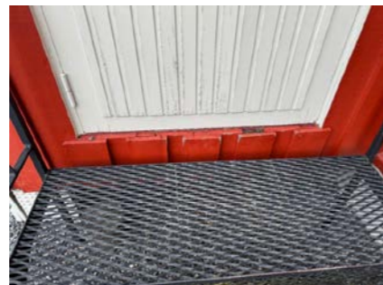
Manglende beslag under hoveddør.
