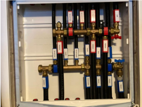
Fordelerskap for rør i rør
