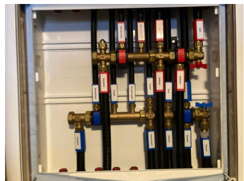
Fordeleskap for rør i rør
