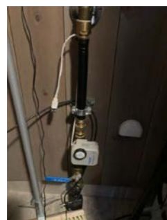
Vannledning med stoppekrane
