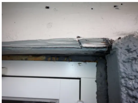
Eksempel på manglende tetting/omramming på vindu etablert i grunnmur.
