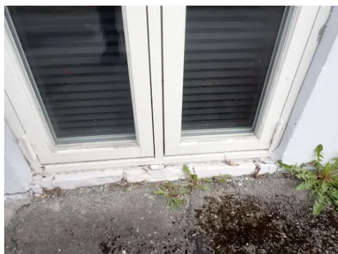
Eksempel på manglende beslag/tetting under bunnkarm på vindu etablert i grunnmur.
