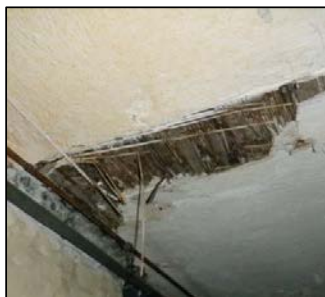
Himling i kjeller med skader i puss.
