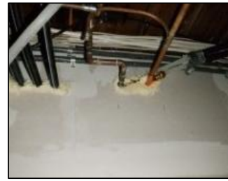
Gjennomføring i kjeller mot ny del av bolig. Det er benyttet byggeskum det er ikke tillatt. Skummet må byttes.
