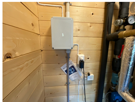
Hovedstoppekran i teknisk rom.
