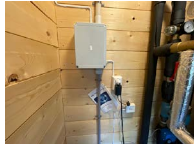
Hovedstoppekran i teknisk rom.
