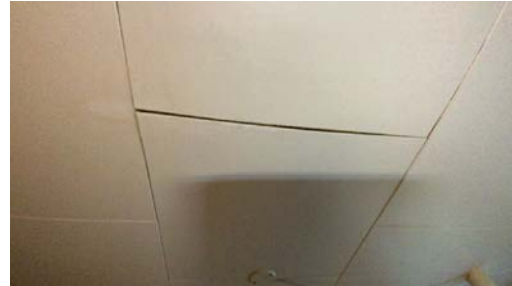
Det er synlig fukt på underliggende kjøkkenhimling.
