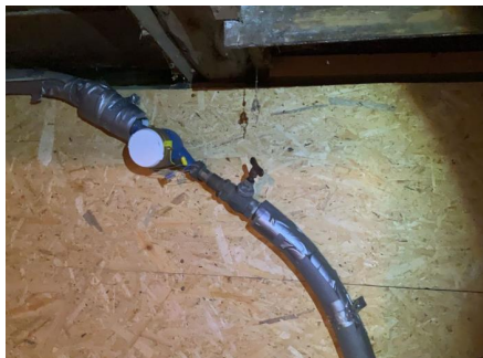
Stoppekran og vanntmåler.
