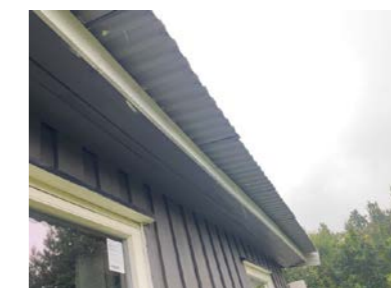
Langt overheng på takplater. Taktekking har ufag,essig utførelse.
