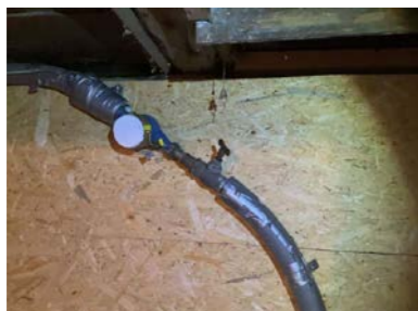
Stoppekran og vannmåler.
