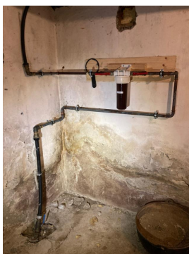
Det er synlige tegn til at det har vært fukt i kjeller.
