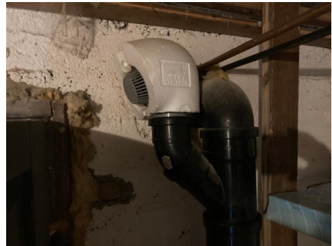
Vakumventil i kjeller.
