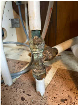
Kobling i kjøkkenskap med irr og tendens til lekkasje.
