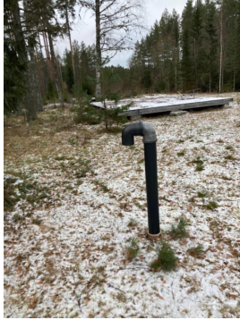
Oppstikk som kan være fra tett septiktank.
