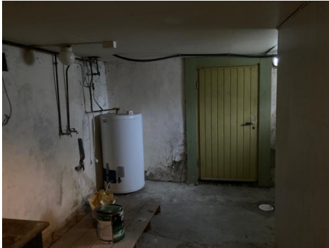
Varmtvannstank i kjellerrom med sluk.
