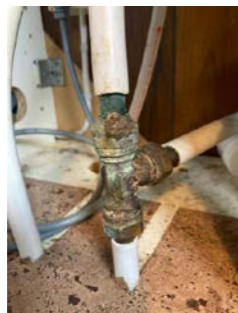
Kobling i kjøkkenskap med irr og tendens til lekkasje.
