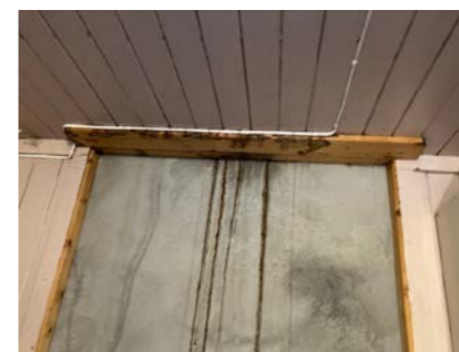
Rennmerker på pipe i loftetasje.
