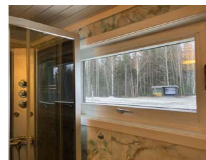
Vindu er i våtsone til dusj, ved renovering må vinduet fuktbeskyttes.
