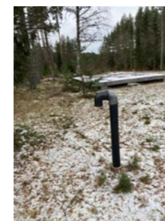
Oppstikk som kan være fra tett septiktank.
