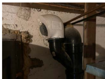
Vakumventil i kjeller.
