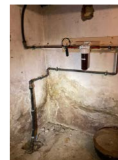
Det er synlige tegn til at det har vært fukt i kjeller.
