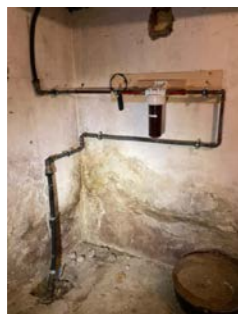
Stoppekran og vannfilter i kjeller. Stoppekran funksjonstestet, ok.
