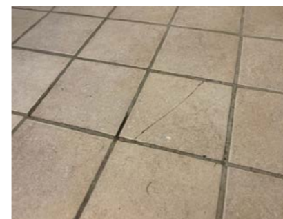
Sprekk i gulvflis.
