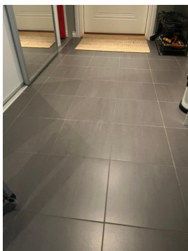
Fliser i entre/gang med "bom".
