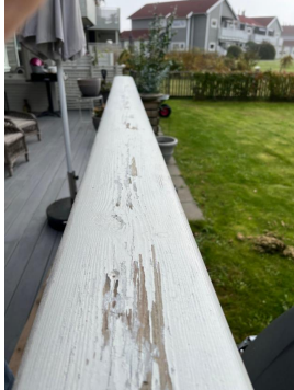
Rekkverk trenger overflatebehandling.
