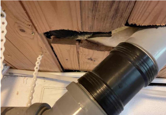
Avløpsrør fra bad 1.etg. Synlig bjelkelag.
