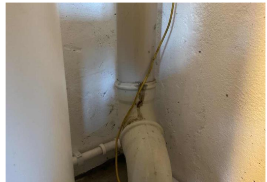
Sprukket muffe på avløpsrør.
