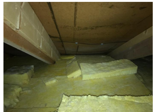
Luftespalte tettet med isolasjon over tilbygg
