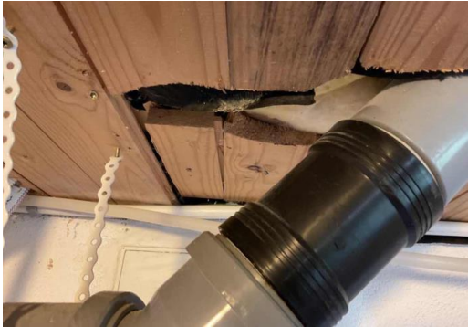
Avløpsrør fra bad 1.etg. Synlig bjelkelag.
