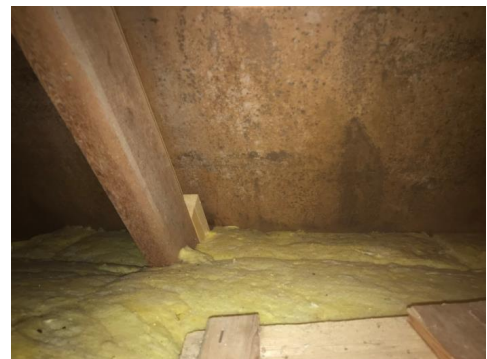
Manglende luftespalte i skråhimling. Noe svertesopp i undertak.
