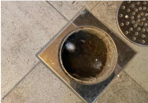
Manglende membran i sluk/gulv.
