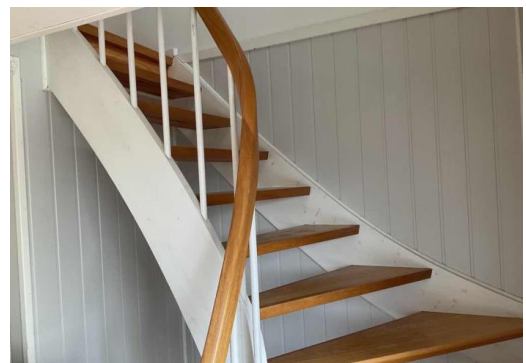
Trapp til loft. Mangler krypsikring
