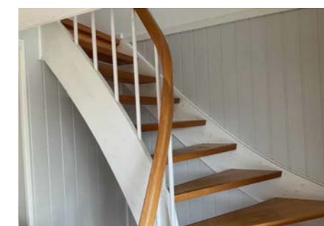
Trapp til loft. Mangler krypsikring
