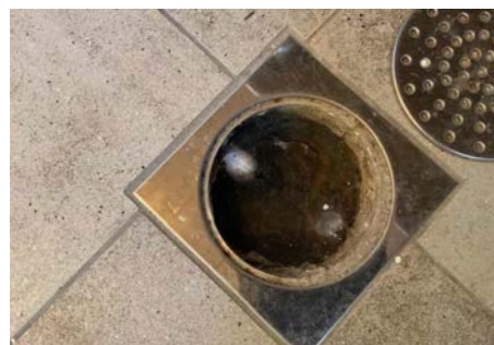
Manglende membran i sluk/gulv.
