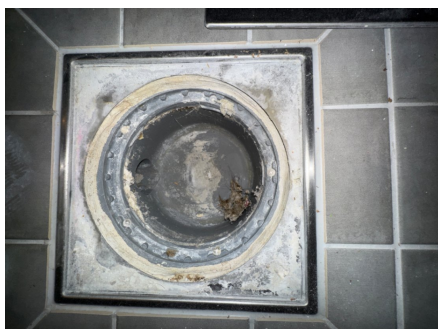
Plastsluk i dusjsone
