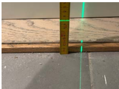
Fallforhold ca. 100 mm overkant gulv ved terskel
