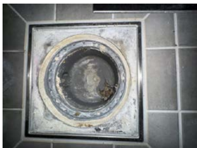
Plastsluk i dusjsone
