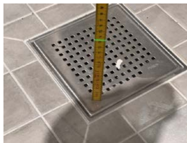
Fallforhold ca. 134 mm topp slukrist i dusjsone
