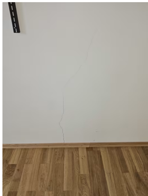
Bilde av riss i mur.
