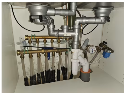
Åpen rørfordeling under kjøkkenvask.
