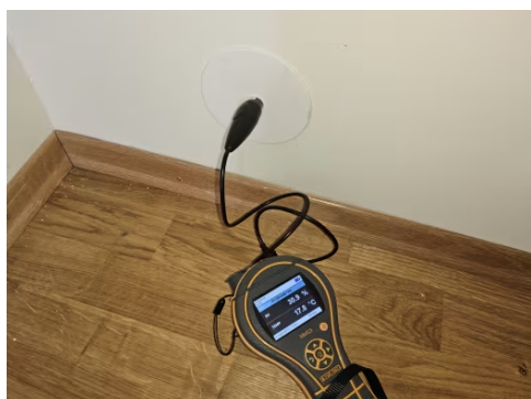
Bilde fra fuktmåling i veggkonstruksjon tilstøtende våtsone.
