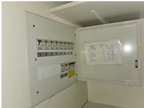
Sikringsskap er plassert i bod.
