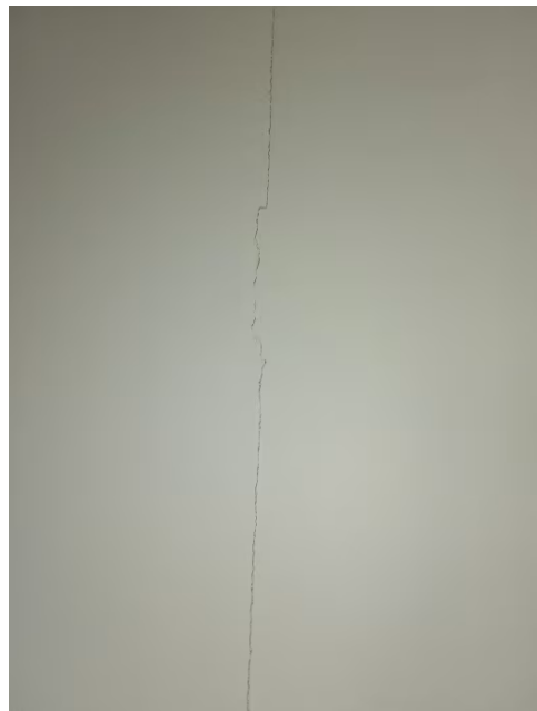
Bilde av sprekk i plateskjøt.
