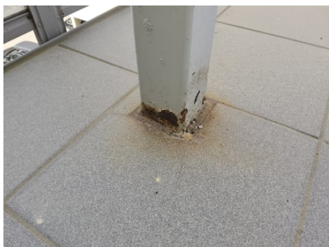
Rust på metallsøyle til overliggende balkong.
