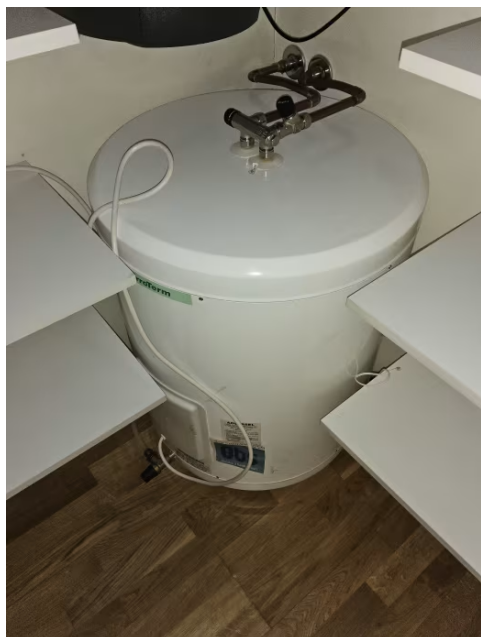
Varmtvannsbereder er plassert i bod.
