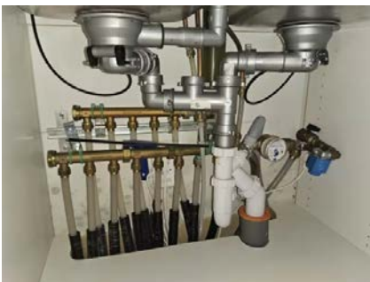
Åpen rørfordeling under kjøkkenvask.
