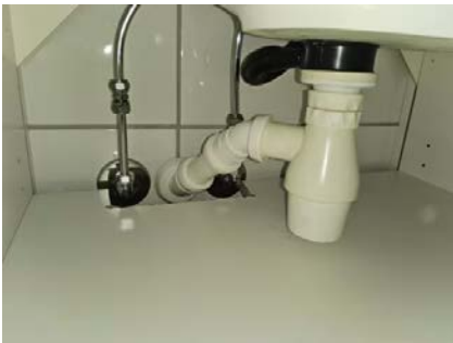
Leiligheten har synlige avløpsrør av plast.
