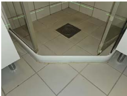
Sluk er isolert inne i dusjsonen.
