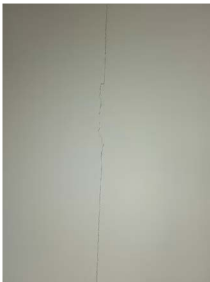
Bilde av sprekk i plateskjøt.
