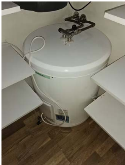
Varmtvannsbereder er plassert i bod.
