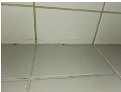
Det registreres sprekker i enkelte veggfliser i dusjsonen.
