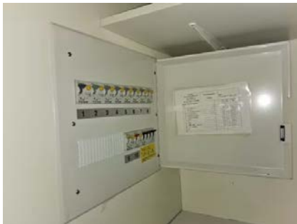
Sikringsskap er plassert i bod.
