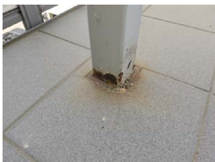
Rust på metallsøyle til overliggende balkong.
