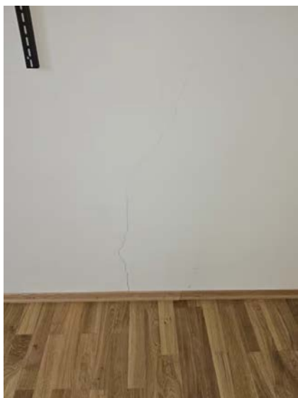
Bilde av riss i mur.
