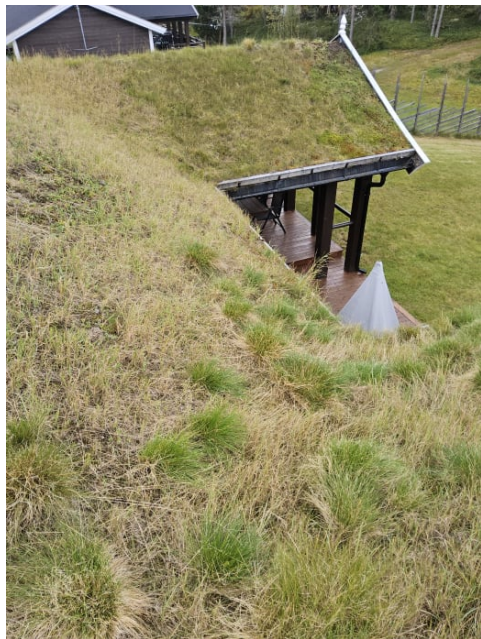
Bilde viser manglende snøfanger.
