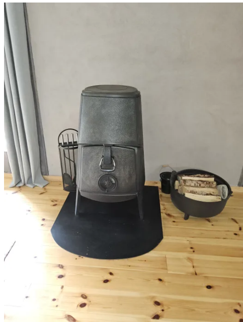
Bilde viser vedovn i stue.
