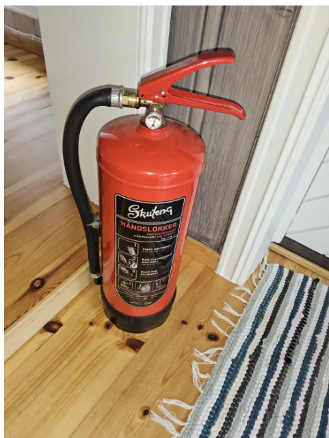
Bilde viser brannslukningsapparat.
