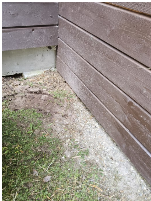
Bilde viser kledning avsluttet for nærme bakken.
