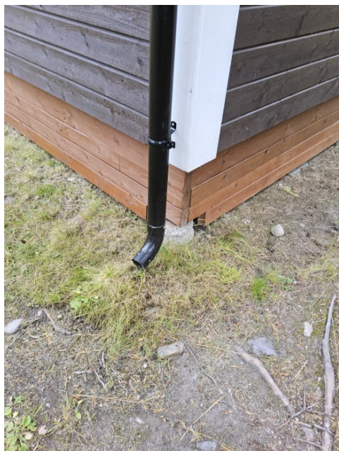
Bilde viser taknedløp avsluttet over bakken.
