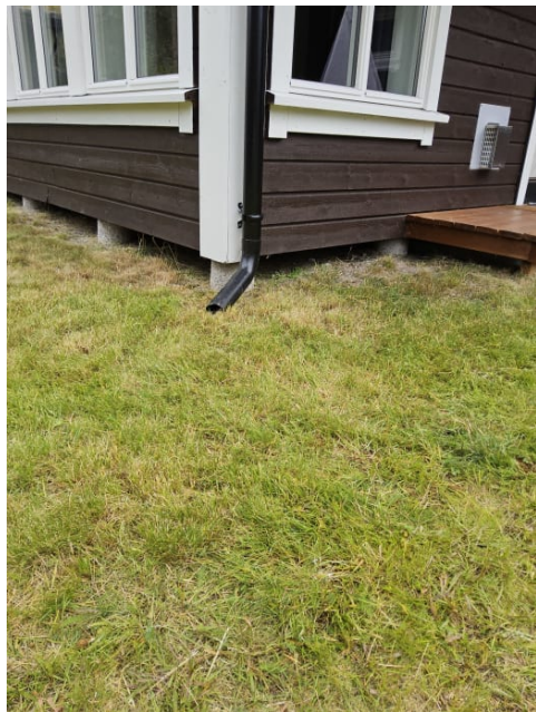
Bilde viser begrenset adkomst til krypkjeller.
