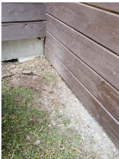
Bilde viser kledning avsluttet for nærme bakken.
