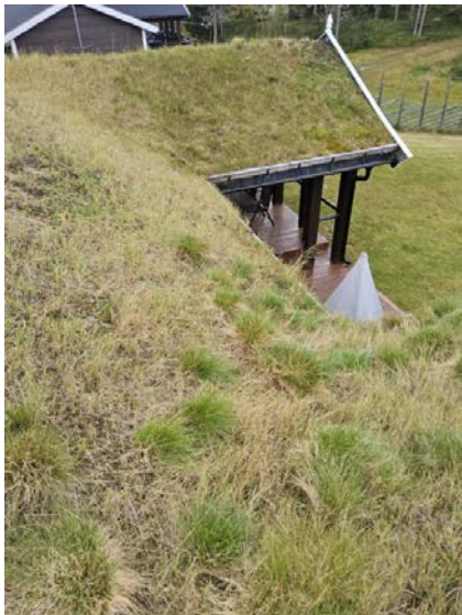
Bilde viser manglende snøfanger.
