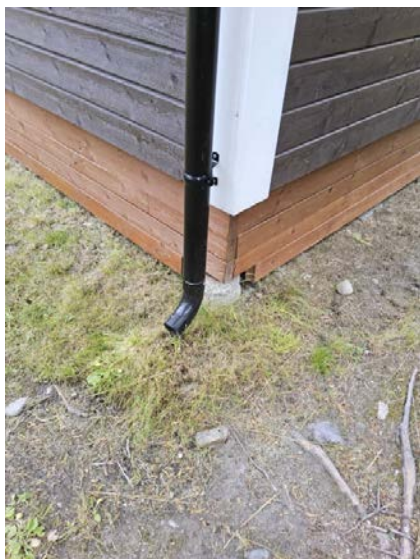
Bilde viser taknedløp avsluttet over bakken.
