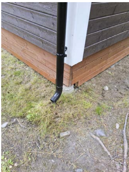
Bilde viser taknedløp.
