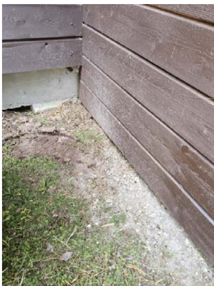
Bilde viser kledning avsluttet for nærme bakken.
