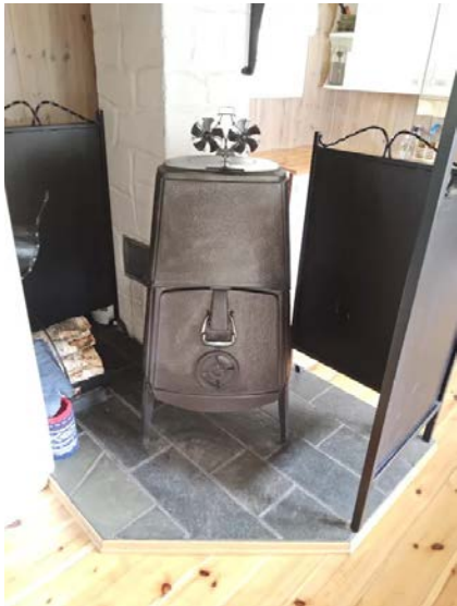
Bilde viser vedovn på kjøkken.
