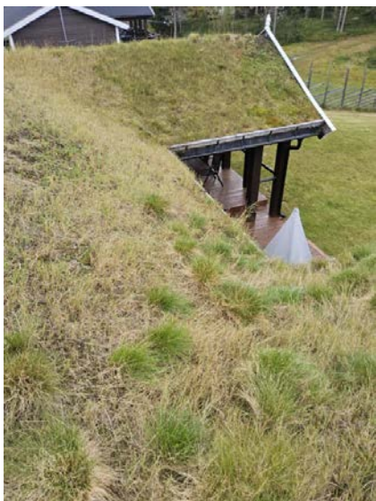
Bilde viser manglende snøfanger.
