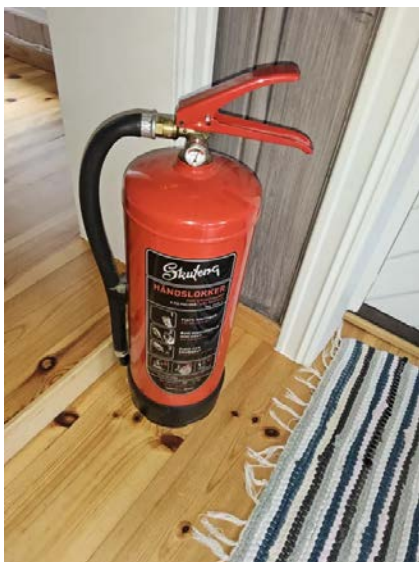
Bilde viser brannslukningsapparat.
