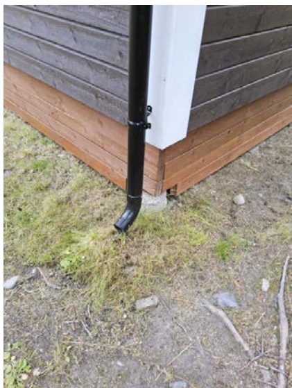
Bilde viser taknedløp avsluttet over bakken.
