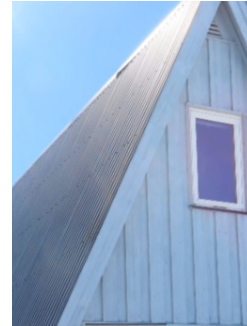
Mønebeslag - manglende innfesting.
