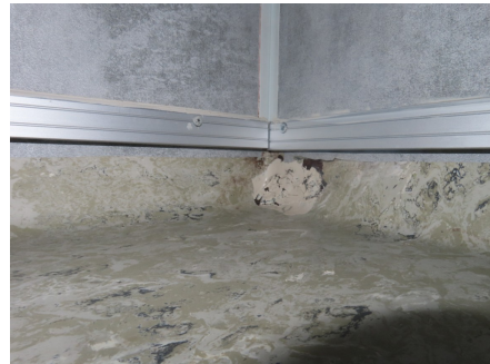
Sveiset sammenføyning i hjørne i dusj. Ses senere reparert/utbedret - pga ukjent årsak.
