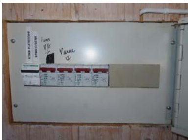
Innv. underskap med vippesikringer.
