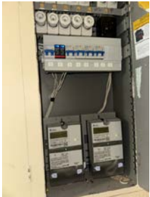
Sikringsskap plassert i felles oppgang.
