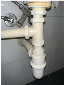
Avløpsrør under servant er tettet med silikon
