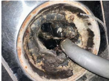
Sluk i plast, plassert under badekar
