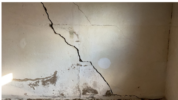
Større sprekk ut mot gårdsplass.
