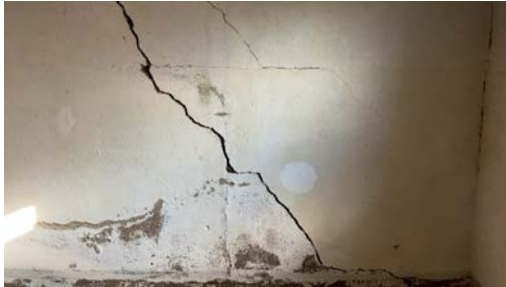
Større sprekk ut mot gårdsplass.
