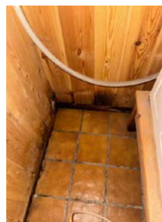
Målt høy fuktighet i vegg vaskerom
