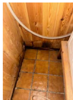
Målt høy fuktighet i vegg vaskerom
