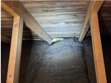
Deformert pappkubbing. Tegn til innvendig kondensering.
