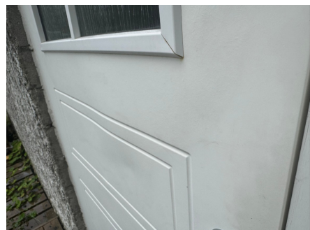
Døren til hybelen har fuktskader.
