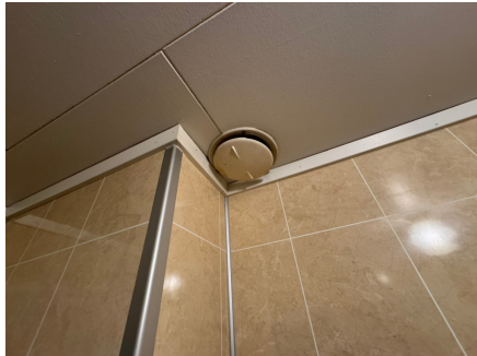
Ventilasjon til badet.
