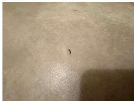
Skade i vinylbelegget.
