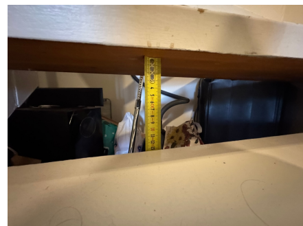
Åpninger mellom opptrinn.
