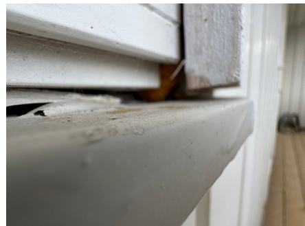
Det er ikke oppbrett på beslaget samt at det har lite fall.
