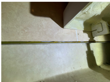
Svikt i fugemassen mellom baderomsplatene og aluminiumslisten.
