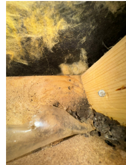
Innvendig i vegg hvor jeg har fuktmålt.
