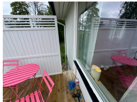
Åpning i rekkverket.
