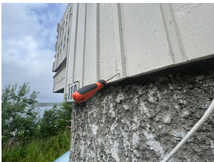
Eksempel på sprette råteskader.
