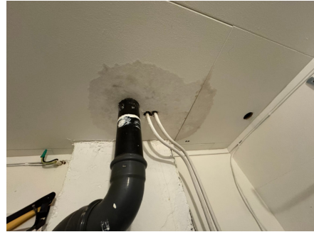
Fuktskjolder i boden i underetasjen.
