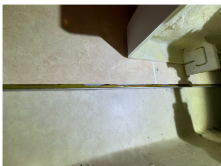
Svikt i fugemassen mellom baderomsplatene og aluminiumsprofilen.
