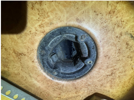
Sluk, klemringen mangler en skrue.
