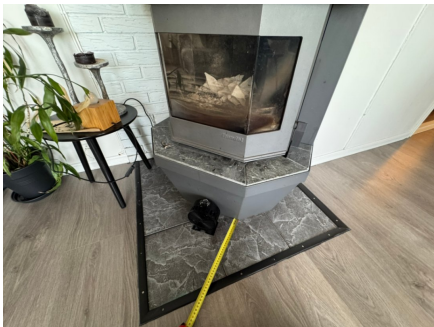
Det er ikke tilfredsstillende ildfast plate under ovnen.
