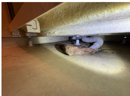
Stein under foten til dusjkabinettet.
