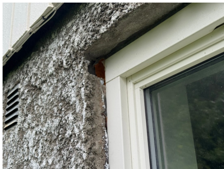
Vindu er ikke tett tilfredstillende på utsiden.
