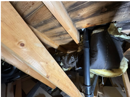
Uisolert rør på loftet.
