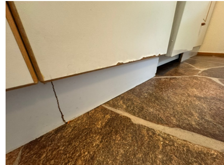
Skader på innredningen.
