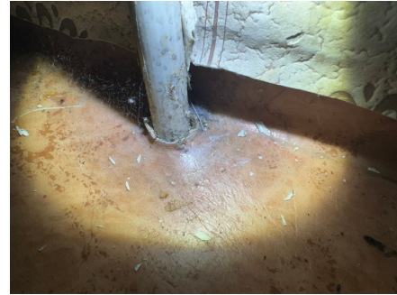
Utettheter på vaskerommet.
