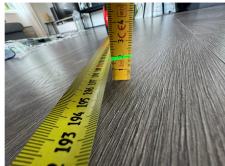
Måling ca to meter fra altandøren
