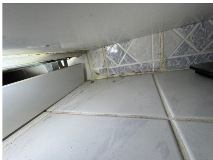
Tegn til fuktskader i nedkanten av platene.
