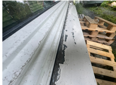
Det er åpning mellom beslaget å vinduet.
