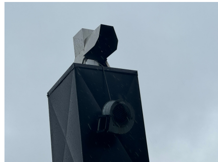
Avtrekksviften til pipen er løs.
