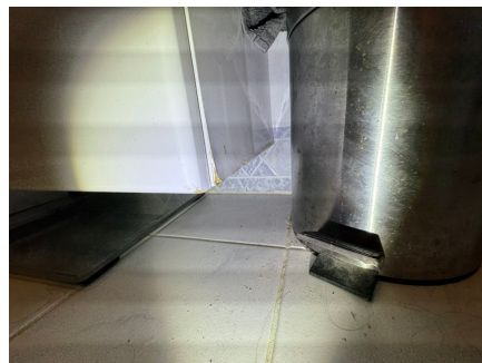
Fuktsvelling i innredningen.
