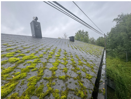
Det er ikke takstige.
