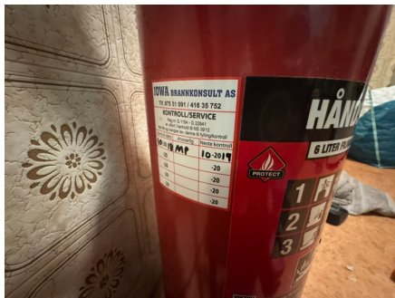
Håndsløkkeren har ikke vært kontrollert.
