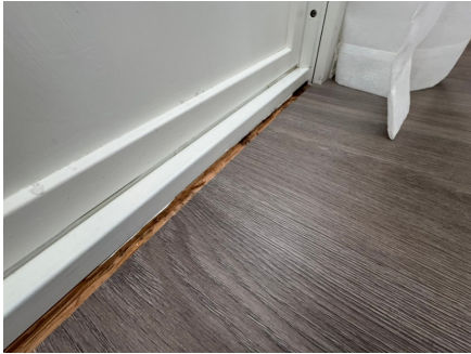
Eksempel på manglende listverk.
