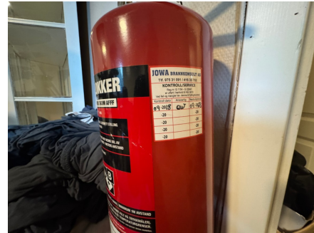
Håndsløkkeren har ikke vært kontrollert.
