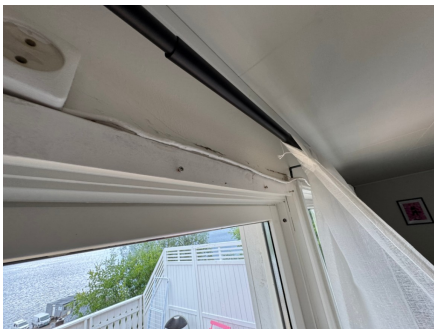
Eksempel på løse ledninger.
