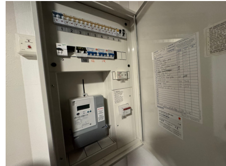
Sikringsskapet til hoveddelen og hybelen.
