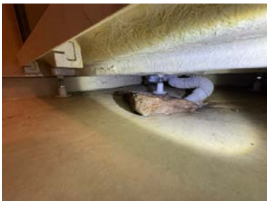
Stein under foten til dusjkabinettet.
