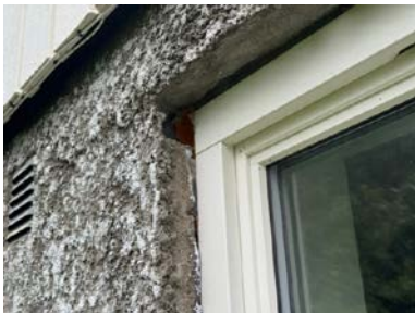
Vindu er ikke tett tilfredstillende på utsiden.
