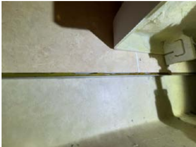
Svikt i fugemassen mellom baderomsplatene og aluminiumsprofilen.
