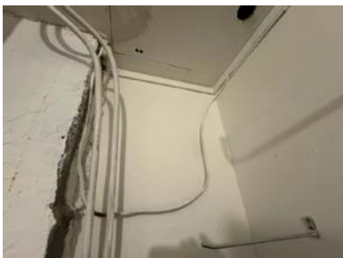
Eksempel på rør som ikke er tilstrekkelig klamret fast.
