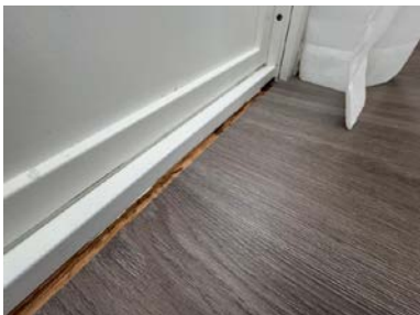
Eksempel på manglende listverk.
