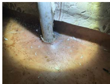
Utettheter på vaskerommet.
