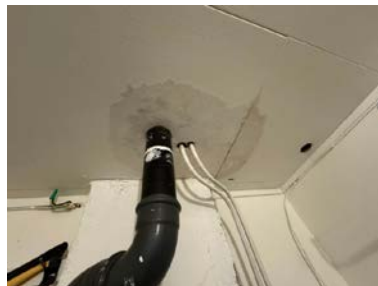
Fuktskjolder i boden i underetasjen.
