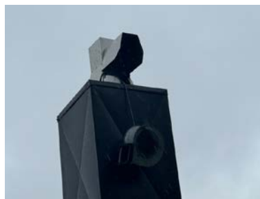
Avtrekksviften til pipen er løs.
