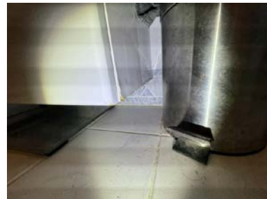
Fuktsvelling i innredningen.
