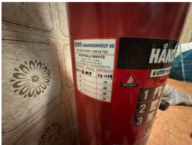
Håndsløkkeren har ikke vært kontrollert.
