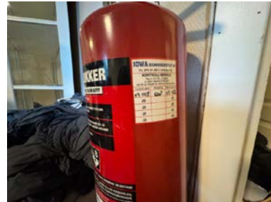
Håndsløkkeren har ikke vært kontrollert.
