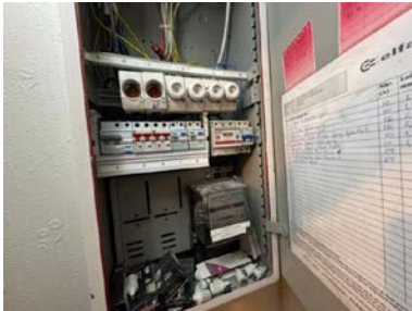
Sikringskapet til leiligheten i underetasjen.
