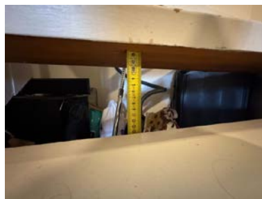
Åpninger mellom opptrinn.
