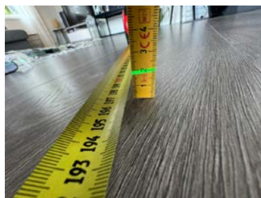
Måling ca to meter fra altandøren
