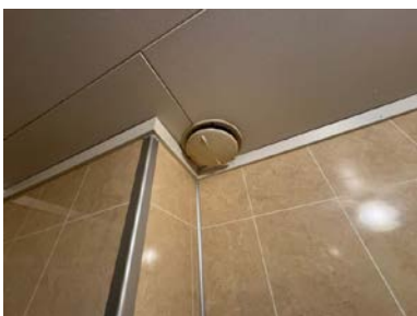
Ventilasjon til badet.
