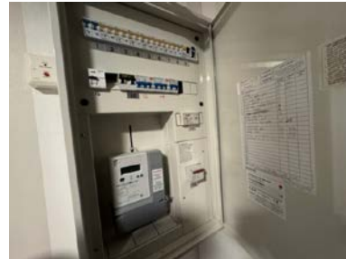
Sikringskapet til hoveddelen og hybelen.
