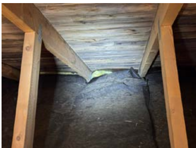
Deformert pappkubbing. Tegn til innvendig kondensering.
