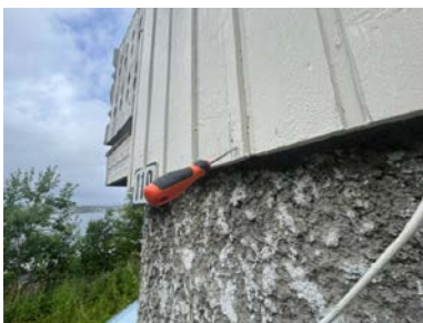
Eksempel på sprette råteskader.
