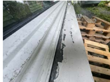
Det er åpning mellom beslaget å vinduet.
