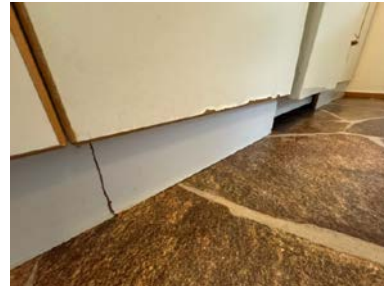
Skader på innredningen.
