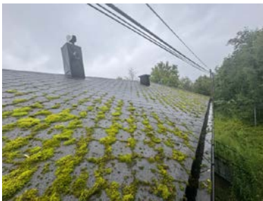
Det er ikke takstige.
