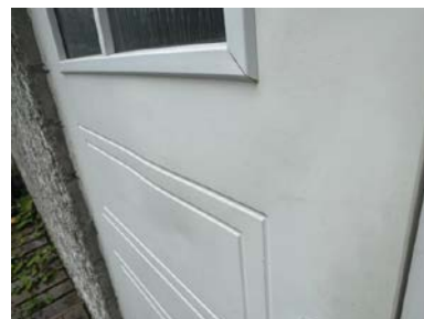
Døren til hybelen har fuktskader.
