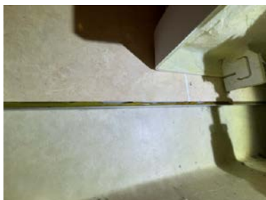
Svikt i fugemassen mellom baderomsplatene og aluminiumslisten.
