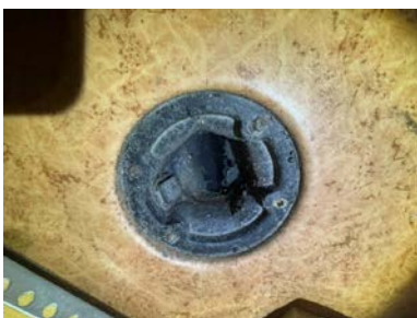
Sluk, klemringen mangler en skrue.
