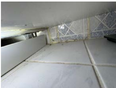
Tegn til fuktskader i nedkanten av platene.
