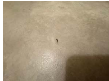
Skade i vinylbelegget.
