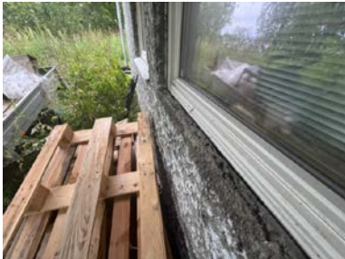
Det er ikke montert beslag på enkelte vinduer.
