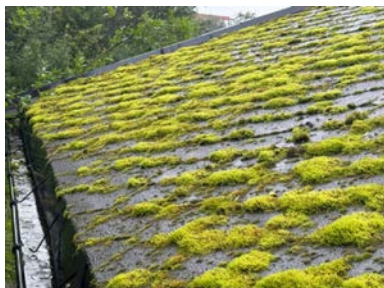
Mose på taktekkingen.
