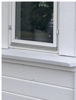
Liten luftespalte mellom vindu og vannbrett
