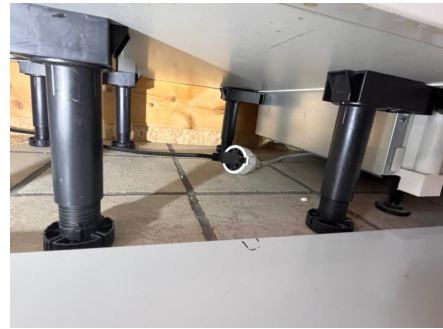
Strøm til oppvaskmaskin.
