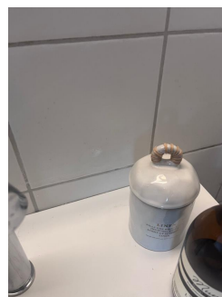
Hull i flis tettet etter befaringen
