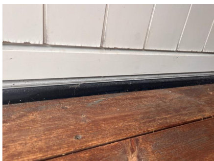
Noe fuktsvelling i nedkant på balkongdør.
