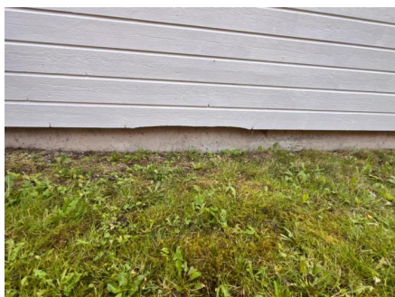
Skade på bordkledning
