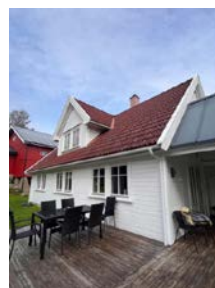
Kledning helt ned på terrassegulv.
