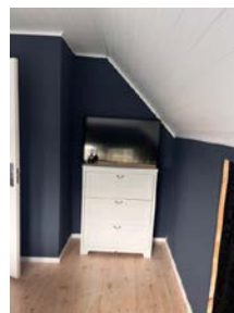
Innkledte sider på pipe på soverom.
