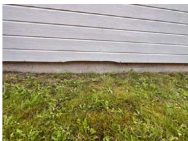
Skade på bordkledning
