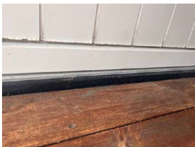
Noe fuktsvelling i nedkant på balkongdør.
