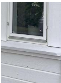
Liten luftespalte mellom vindu og vannbrett
