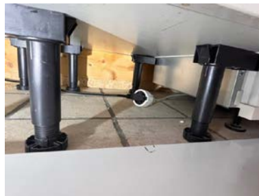
Strøm til oppvaskmaskin.
