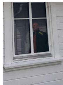
Liten luftespalte mellom vindu og vannbrett samt mellom omramming og vannbrett.
