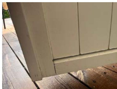
Noe fuktsvelling i nedkant på balkongdør.
