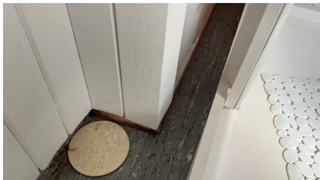
Manglende tettesjikt i våtsone
