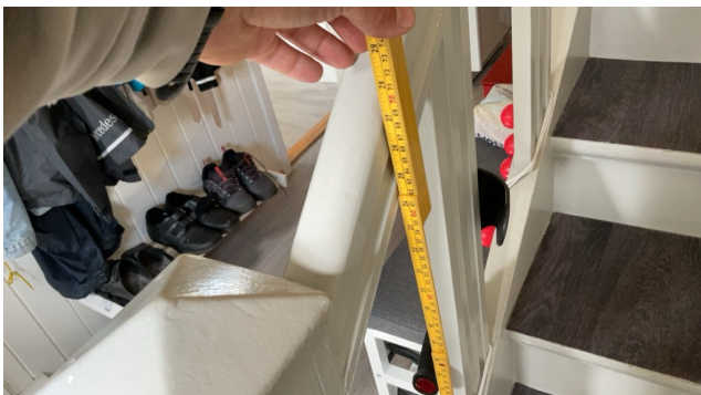
Høyde rekkverk er under krav
