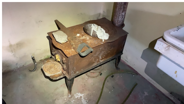
Rustskader på ovner i kjeller
