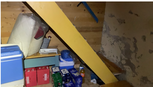
Manglende rekkverk og håndløper i trapp til kjeller
