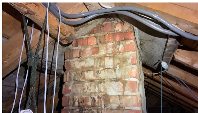
Fuktskjolder på pipe
