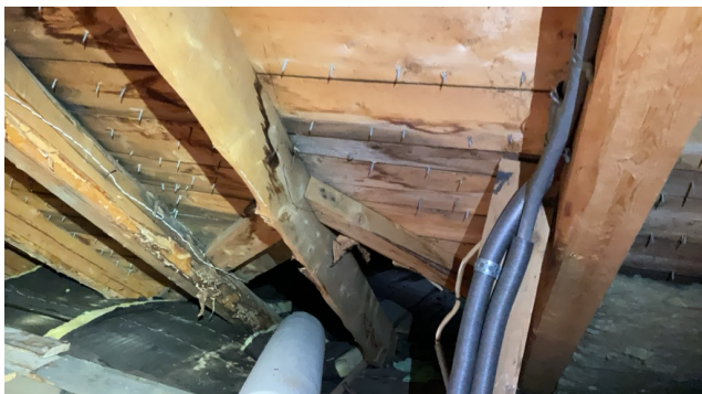
Fuktskjolder i i undertak ved grad
