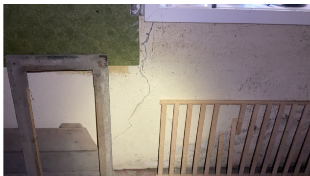
Sprekker i kjellermur
