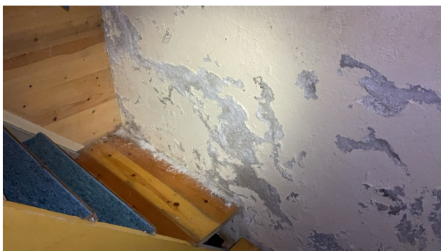
Fuktskjolder og salt på yttermurer
