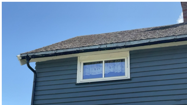
Nedbøying av renne, synlig slitasje
