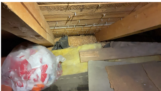
Synlig isolert med flis, anbefales utskifting og etterisolering. Begrenset lufting av takkonstruksjon i loft
