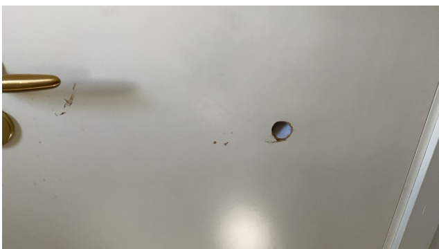
Skade på dør
