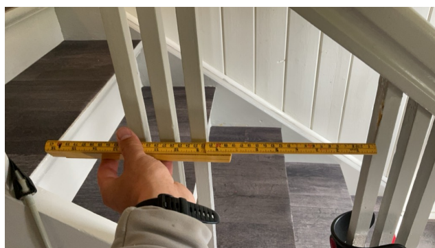
Åpning i rekkverk er over krav
