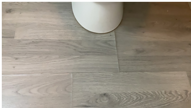
Skade på gulv ved klosett
