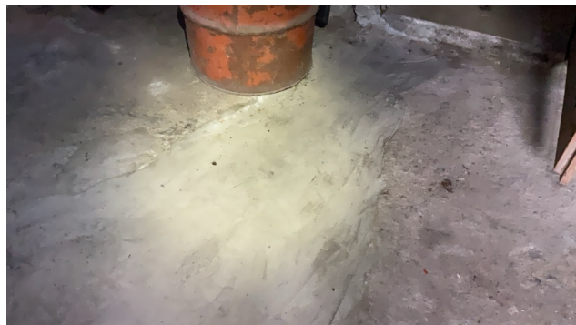
Synlig slissing av gulv i kjeller, nærliggende oppgradert dels bunnledning i enkelte rom
