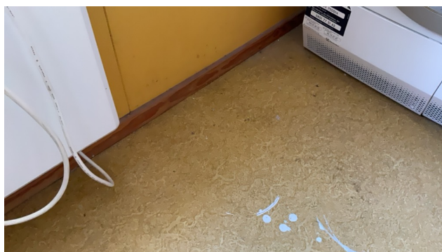
Manglende tettesjikt i vegg og ikke montert sluk
