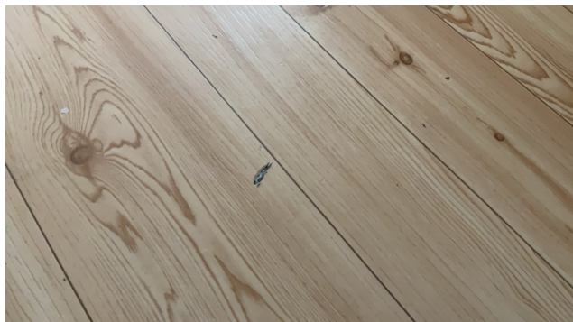
Merker og hakk i gulvbelegg på enkelte rom
