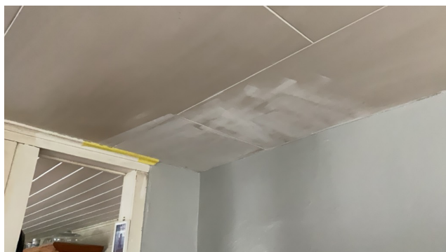
Må påregnes oppussing
