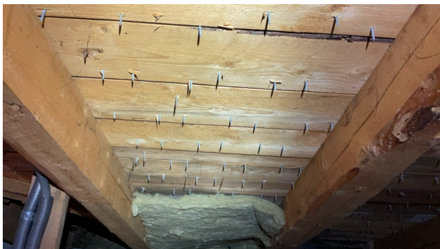
Spikergjennomslag via undertaktro fra tekking
