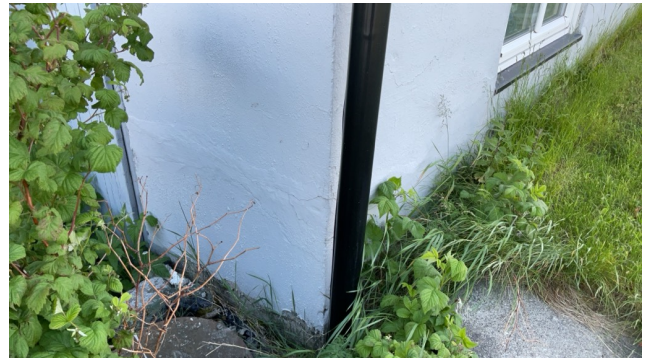
Sprekk i mur
