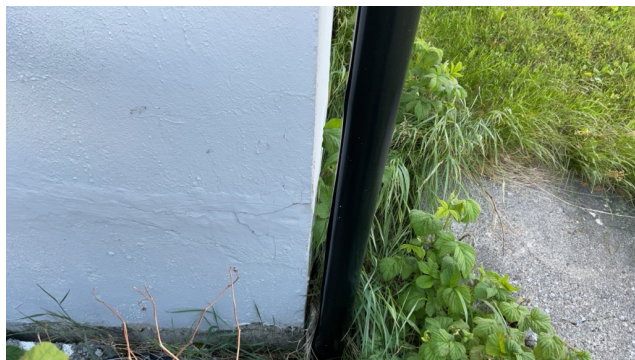
Frostspreng på nedløp
