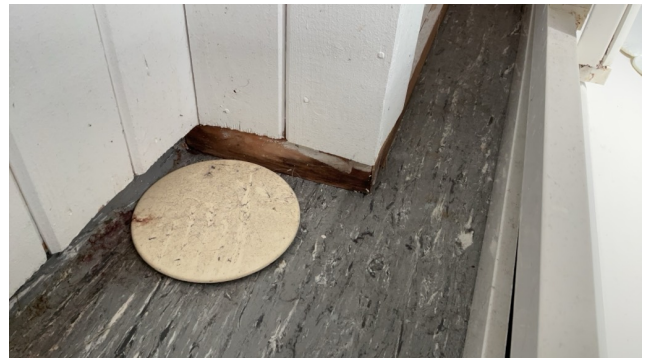
Ikke fuktsikring i overgang gulv/vegg
