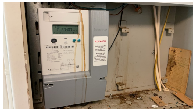
Registrert rennemerke i skap, ukjent årsak og anbefaler nærmere undersøkelse
