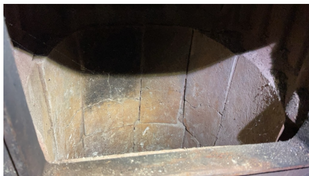
Skader på innerplater i ovner
