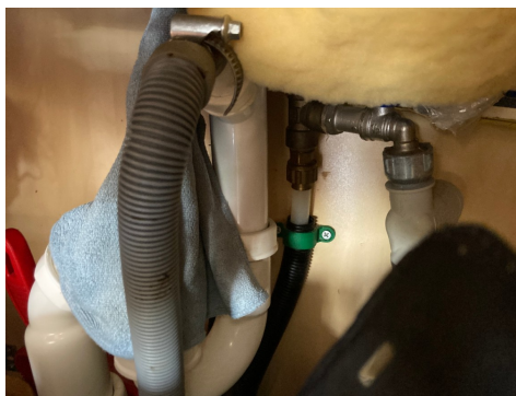
Mangler endekappe på rør
