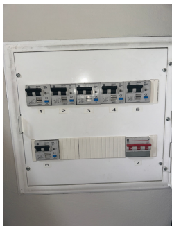
Sikringsskap med automatsikringer.
