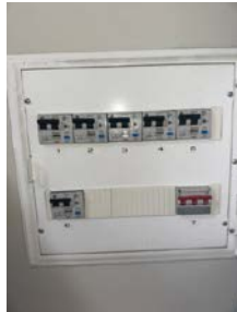
Sikringsskap med automatsikringer.
