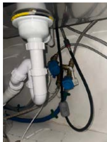
Røropplegg i kjøkkenbenk med Waterguard
