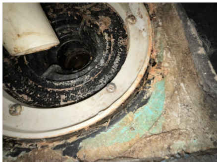
Mangler mansjett rundt sluken
