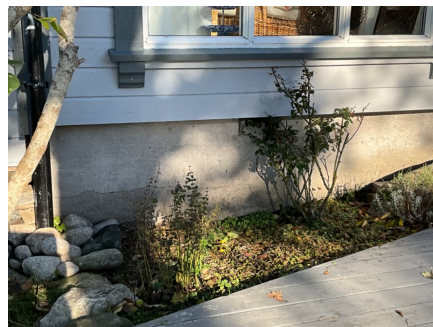
Mindre riss i murene.
