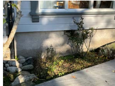
Mindre riss i murene.
