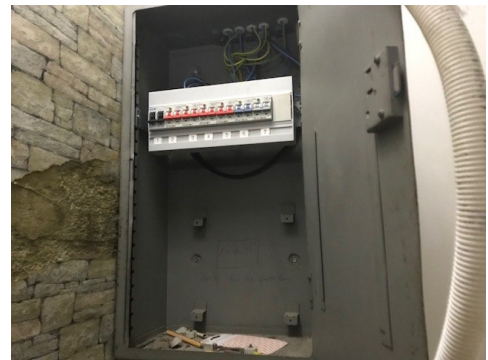
Gammelt sikringsskap i kjeller.
