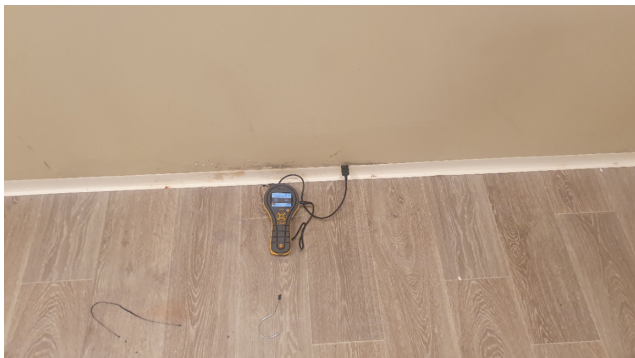
Forhøyet fuktverdi i bakvegg mot sør. Ytterligere kartlegging av skadeomfang må utføres.
