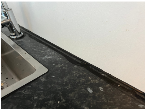
Noe ufagmessig og siliconsøl ved fuger mellom benkeplater og vegg.
