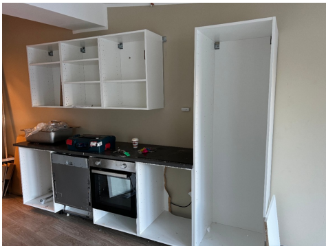
Kjøkkeninnredningen er ikke ferdig montert.
