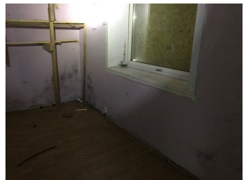
Bruksslitasje i underetasje.
