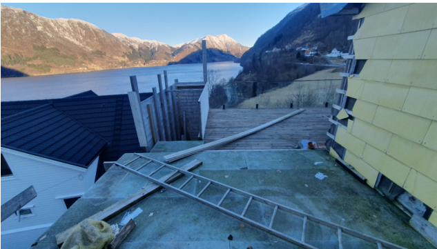
Dels manglende rekkverk og tettesjikt/membran
