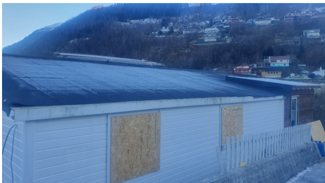
Indikasjoner på lekkasje i yttervegg.
