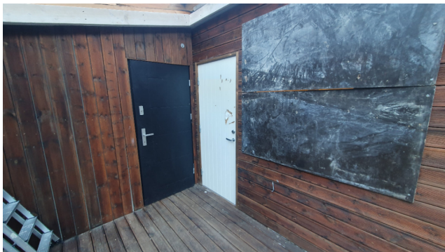
Skade på inngangsdør mot nord.
