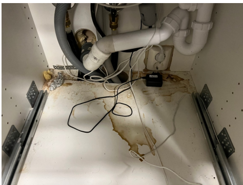
Eldre fuktmerker i skap under vask.
