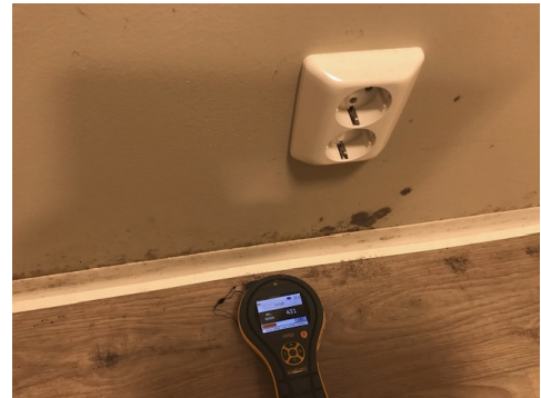
Fuktskade i yttervegg mot sør.
