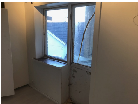
Terrassedører underetasje har knust glass og dørene er skummet igjen.
