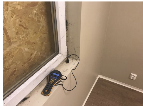
Fuktskade rundt vinduer mot øst.
