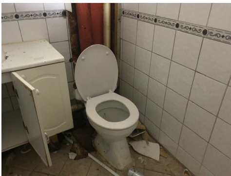
Avløpsrør i plast og støpejernsrør
