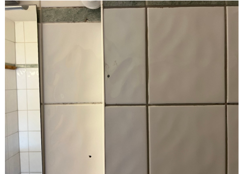
Hull etter tidligere oppheng i dusjsone.
