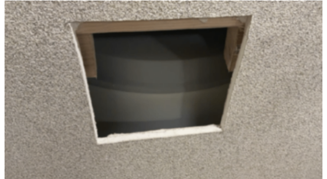
Varmtvannsbereder i sjakt, lite tilgjengelig.
