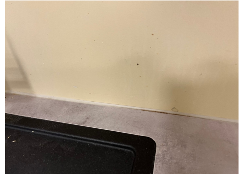
uger mellom vegg og benkeplater ved vask
