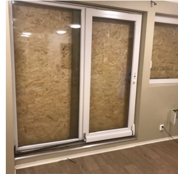
Terrassedør i 1. etasje mot vest er defekt og må repareres/skiftes.
