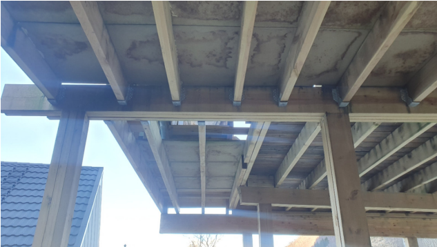
Fuktskader i sponplategulv
