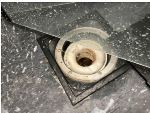
Plastsluk i dusjsone.
