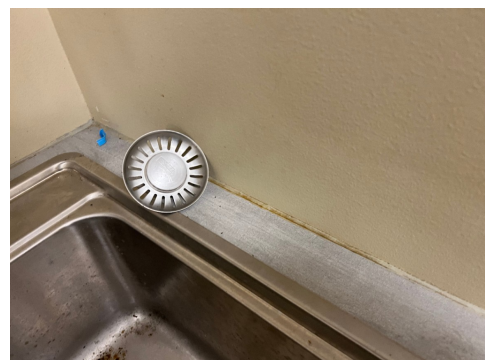
Slitasje på fuger mellom benkeplater og vegger.
