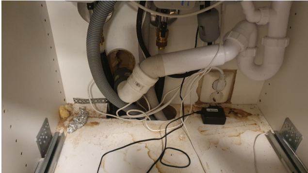
Det mangler stengemuffe i kjøkkenskap.
