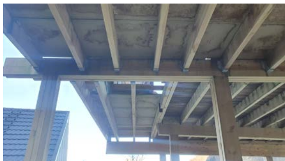
Fuktskader i sponplategulv
