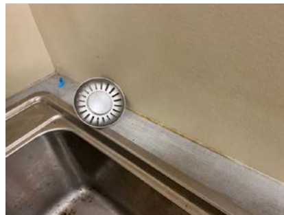
Slitasje på fuger mellom benkeplater og vegg.
