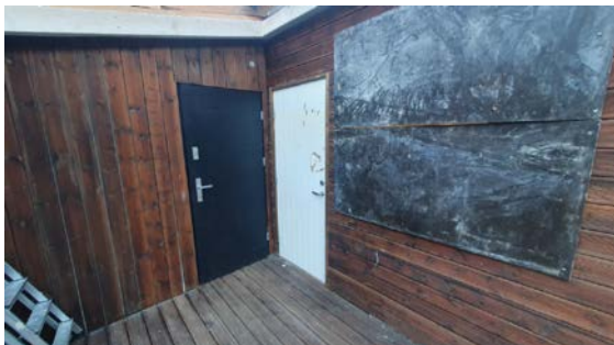
Skade på inngangsdør mot nord.
