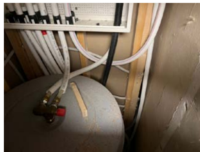
Varmtvannsbereider 2 etasje (mot vest) står i innkasset sjakt og er dårlig tilgjengelig.
