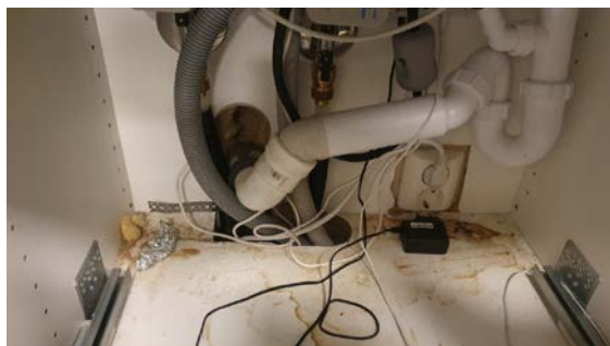
Det mangler stengemuffe i kjøkkenskap.
