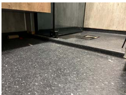
Det er laget oppkant mot dusjsone.
