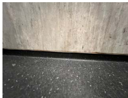
Åpninger mellom baderomsplater og monteringslist.
