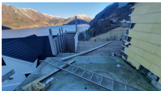
Dels manglende rekkverk og tettesjikt/membran
