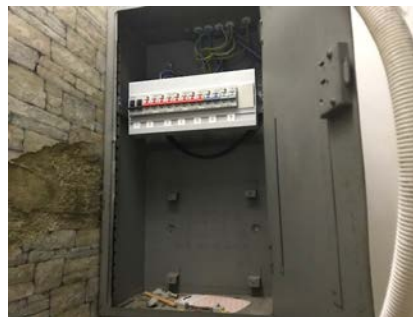
Gammelt sikringsskap i kjeller.
