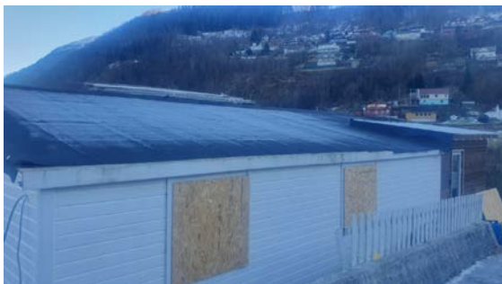
Indikasjoner på lekkasje i yttervegg.
