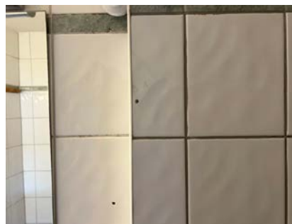
Hull etter tidligere oppheng i dusjsone.
