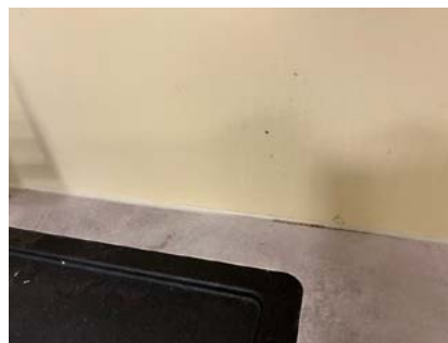
uger mellom vegg og benkeplater ved vask
