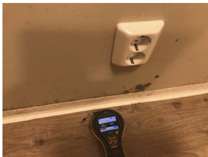
Overflatesøk viser forhøyede fuktverdier i gulv mot yttervegg mot sør.
