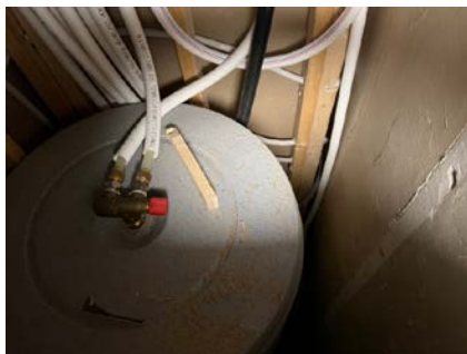
Varmtvannsbereder er plassert i sjakt i tilknytning våtrom.
