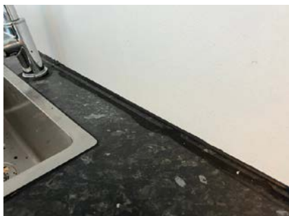
Noe ufagmessig og silikonsøl ved fuger mellom benkeplater og vegg.
