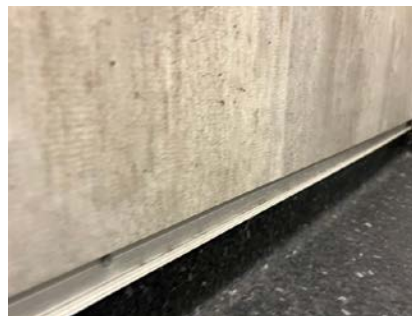
Baderomsplater ligger ikke ned til monteringslist.
