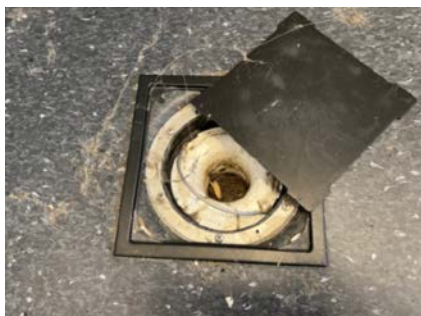
Plastsluk i dusjsone.
