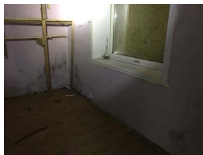
Bruksslitasje i underetasje.
