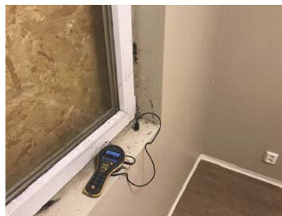
Fuktskade rundt vinduer mot øst.
