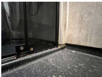
Åpent mot gips i dusjone tettet med fugermasse.
