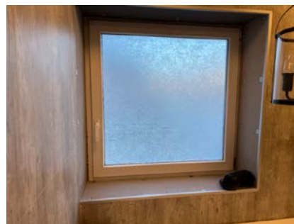
Synlige litexplater som foringer i vindu ved badekar.
