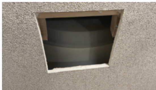
Varmtvannsbereder i sjakt, lite tilgjengelig.
