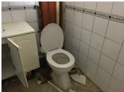
Avløpsrør i plast og støpejernsrør
