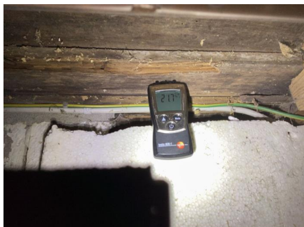
Fuktinnhold i treverk på over 21 vektprosent.
