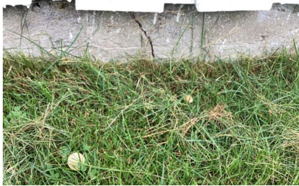
Eksempel på sprekke i grunnmur.
