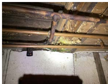
Det er noen råteskader i himling.
