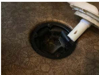
Sluk av plast med klemring.
