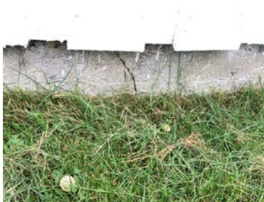
Eksempel på sprekke i grunnmur.
