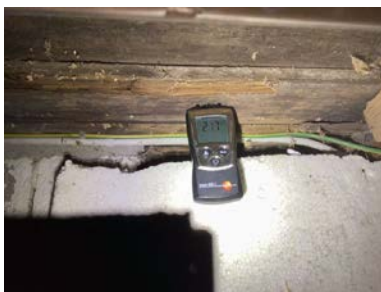
Fuktinnhold i treverk på over 21 vektprosent.
