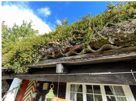
Eternittak under torv.
