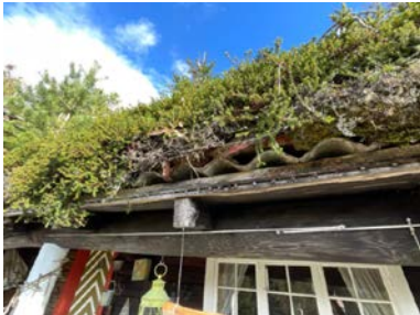
Eternittak under torv.
