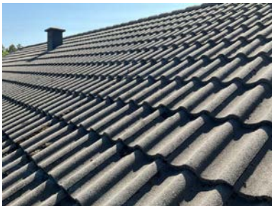
Enkelte knekt stein må forventes.
