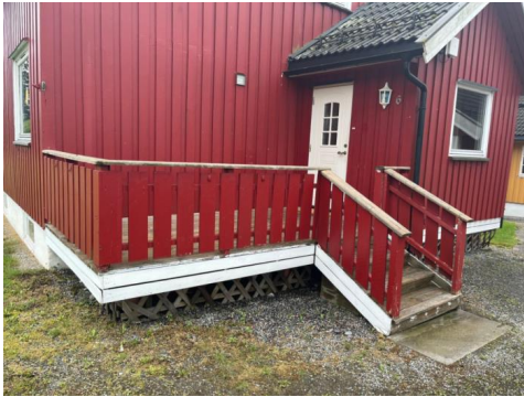
Terrasse til inngangsparti har manglende vedlikehold.
