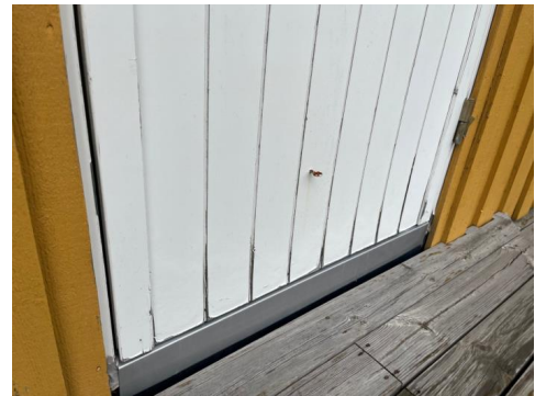
Terrassedør har fuktskader.
