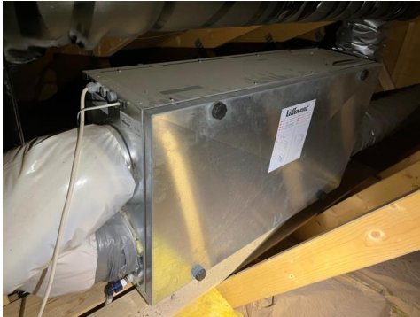
Motorenhet til balansert ventilasjon på møneloft.
