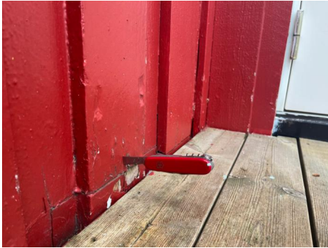
Kledning med råteskader.
