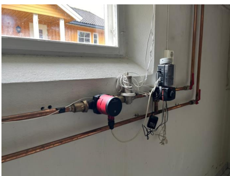
Styring for vannbåren varme til nabohus.
