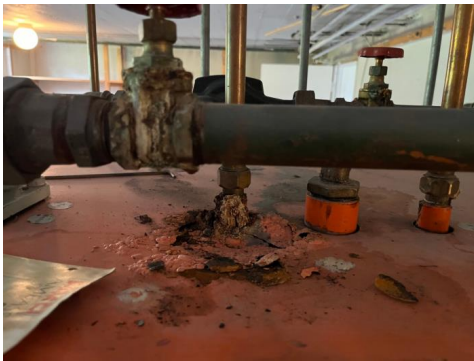
Rust på topp av kjele.
