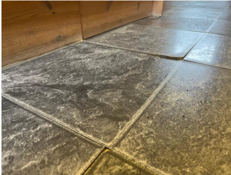
Kjøkkengulv med skader.
