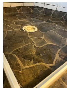
Vannest viste at bruksvann ikke renner til sluk.
