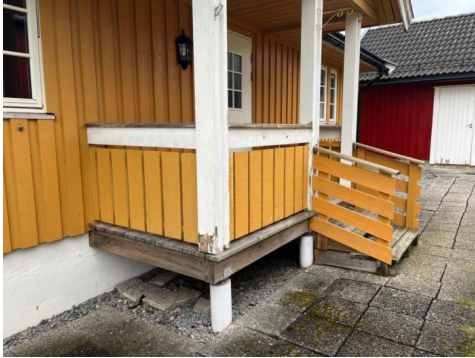
Terrasse til inngangsparti med manglende vedlikehold.
