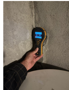
Fuktsøk på nord/østre hjørne viste unormale verdier.
