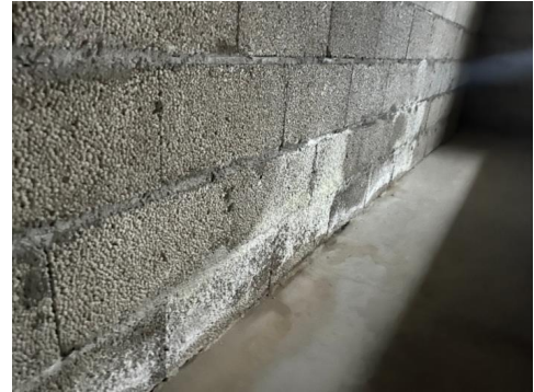
Synlig tegn på fukt fra terreng på sørvegg.
