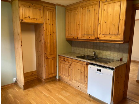
Pipe på kjøkken er delvis dekket av kjøkkenskap.
