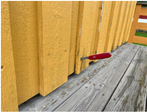
Råteskader i enkelte bord.
