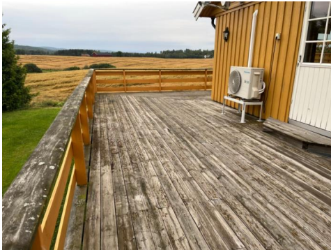
Terrasse mot sør og vest med manglende vedlikehold.
